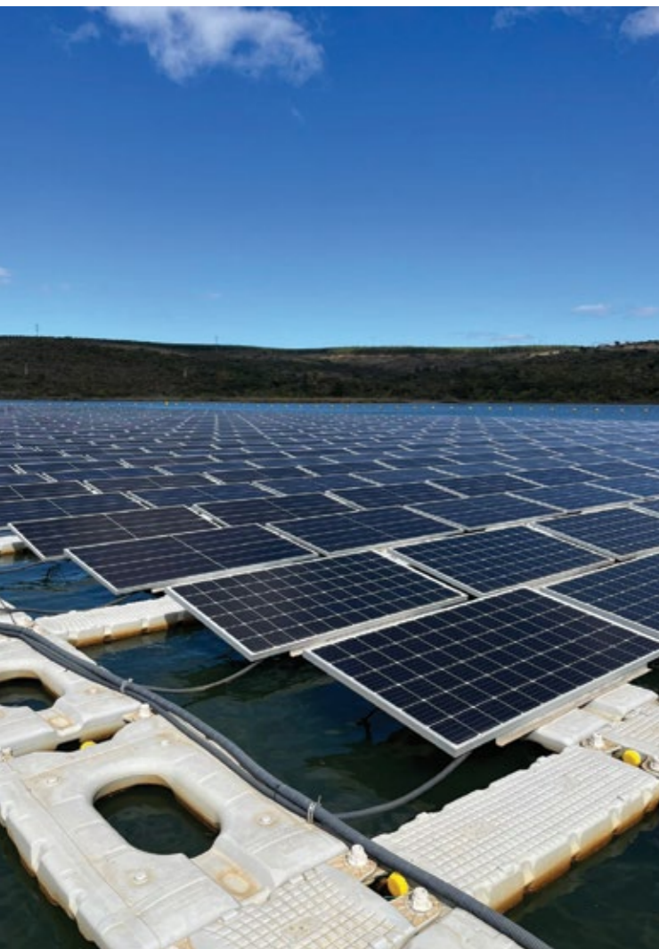
Vista parcial da Usina Fotovoltaica Flutuante. Foto: Ascom - Aedas
